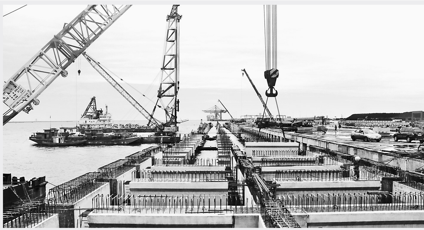
日前,伴随着打桩船上最后一次响锤,由中交一航局一公司第十七项目部承建的河北钢铁国际物流有限公司通用散货码头完成全部沉桩施工。据悉,该散货码头建成后,将进一步提升渤海新区散杂货运输能力。 宁跃 郭震摄
