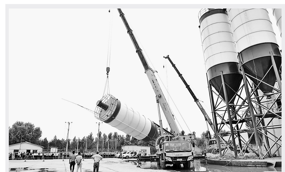
日前,非法占用廊坊开发区小哲堡村耕地的3个搅拌站21个混凝土搅拌罐被拆除,廊坊开发区打响了清理“双违”攻坚战的第一枪。高振永摄
