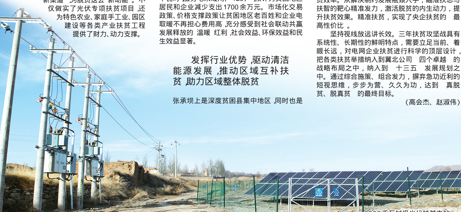
300千瓦村级光伏扶贫电站。
