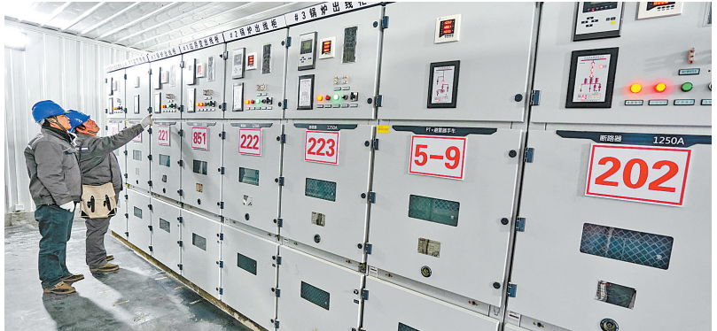
12月14日,国网怀来县供电公司工作人员在检查供电设备。目前该县煤改电、供暖试点工程进展顺利,预计可减排二氧化碳28万吨、二氧化硫8600吨,进一步优化空气质量。
