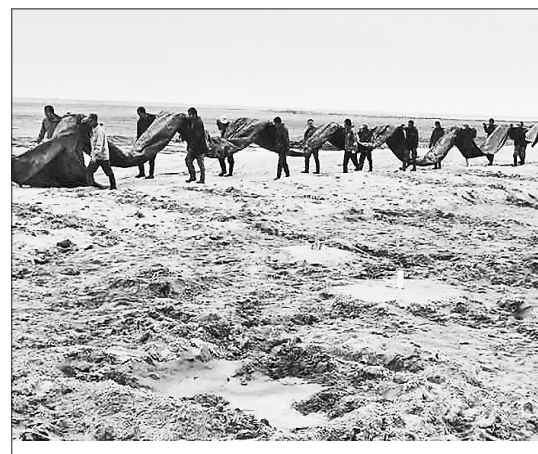
日前,由中建路桥渤海新区科创园第三项目部建设的黄骅港综合港区港前西路二期工程正在紧张建设,铺膜工人抬膜进场施工。该工程位于黄骅港综合物流园区内,是黄骅港码头泊位建设以及综合物流园区和港口物流的基本通道。 通讯员 李 俭 摄
