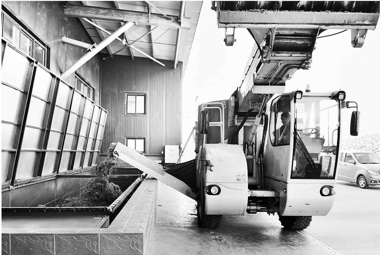
定州的规模化生物天然气示范项目以畜禽粪污、厨余垃圾为主要原料生产沼气并提纯为生物天然气,实现了农废弃物的循环利用。目前,投资2.6亿元的一期项目已经投产,年可处理奶牛场粪污18万吨,年产730万立方米高纯度天然气或发电1600万千瓦时。这是工人运用现代化设备往料池投放秸秆原料。于常见摄
