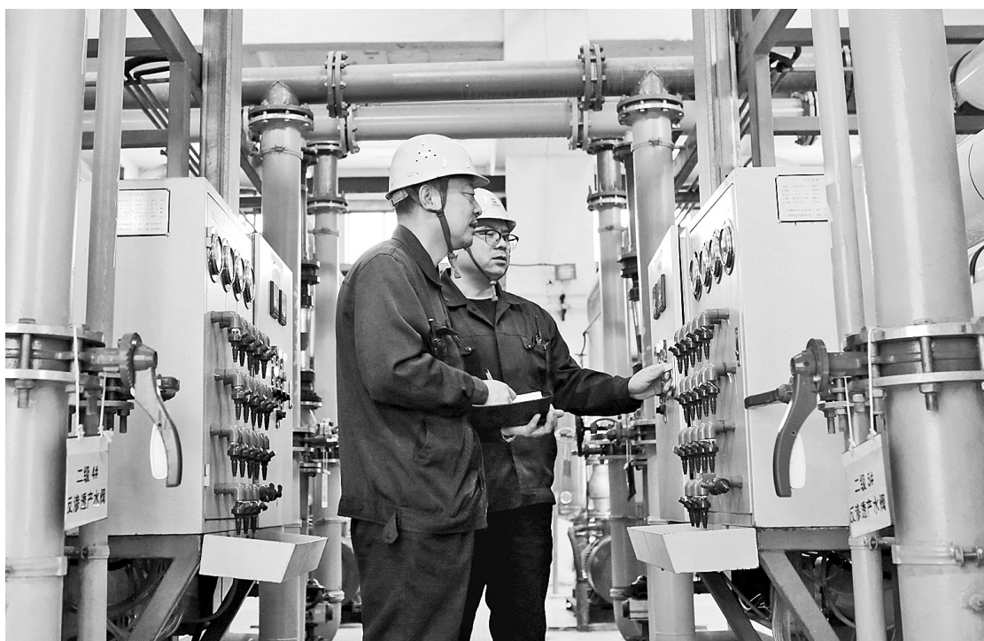
近日,河钢宣钢设备能源部职工在对反渗透保温设备进行检查。该部强化在线设备点检力度,做到有挂牌、有记录,有效提升了设备运行效率。今年2月以来,设备可开动率环比提高0.2%。 记者 王雪威 通讯员 李巍摄
