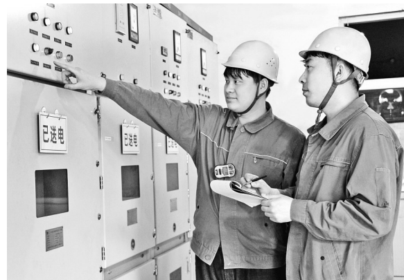
河钢宣钢设备能源部以提升设备精益化管理水平、服务产线为抓手,加强在线设备点检、维护力度,为提升产品档次奠定坚实基础。图为技术人员在对高压柜进行细致点检。 通讯员 牛晓博 记者 李艳红摄
