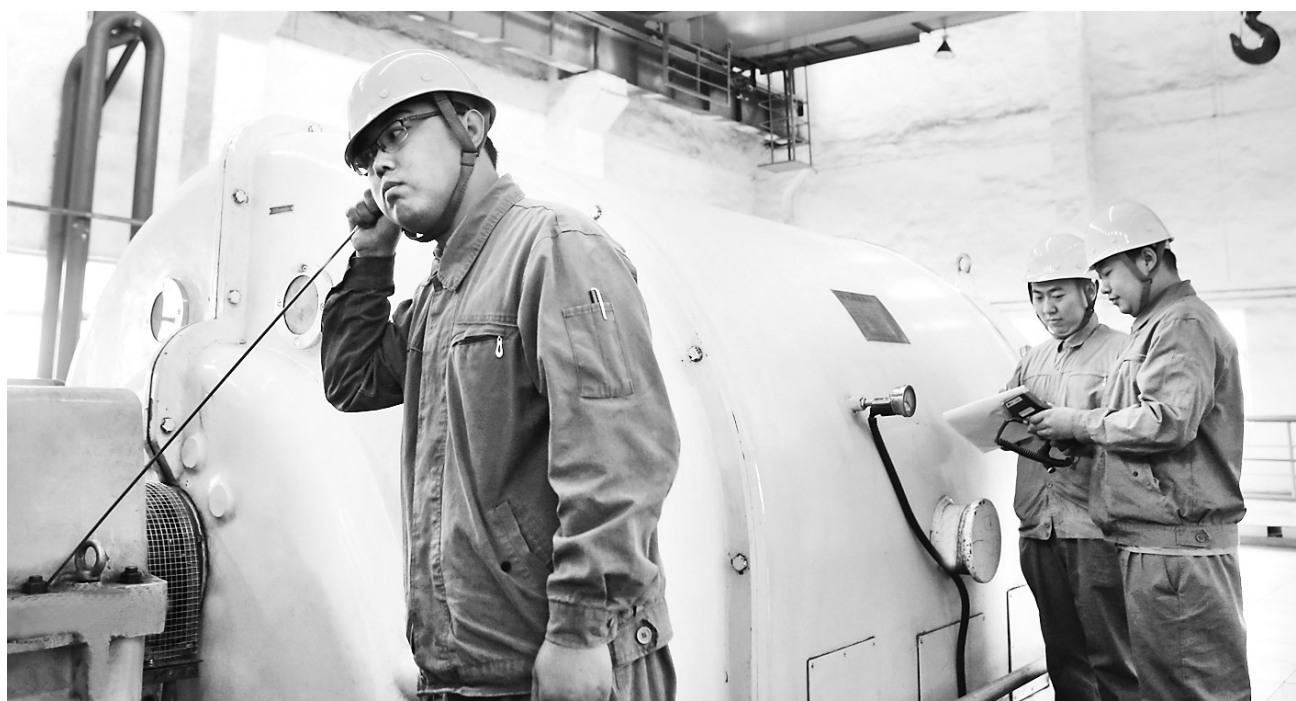
近日,河钢钢铁设备能源部技术人员在对汽轮发电机进行测振点检。企业技术人员以“保安全、增效益”为目标,对工艺设备、安全防护设施等情况进行全面督导、检查,为提升产线竞争力提供坚实保障。
