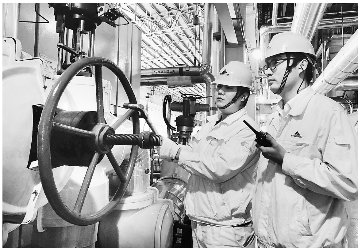
坐落于渤海新区的国华沧东电厂不断加强设备精益化管理,多方面开展设备技术改造,着力提高系统安全性、可靠性以及节能降耗、环境保护等应达到的重要指标,为机组健康运行奠定基础。这是维护人员在沧东电厂2号机组直流系统升级改造项目的参数进行核对。高腾腾 李秀敏摄
