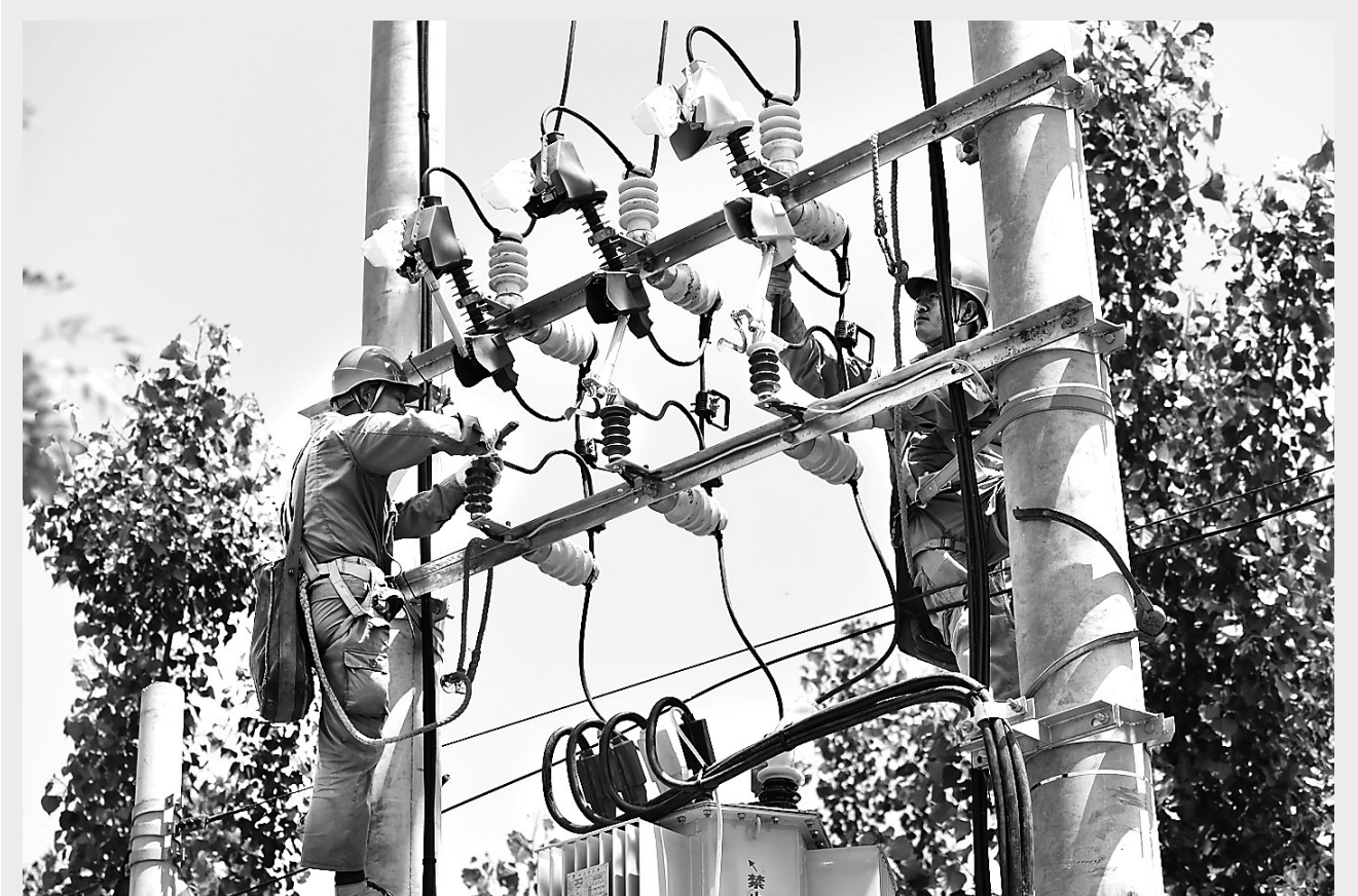
日前,国网巨鹿县供电公司施工人员在堤村乡西佛寨村安装配变变压器。今年以来,国网巨鹿县供电公司实施乡村电网改造升级工程,计划年内完成142公里10千伏线路改造,新增配变变压器148台,可为59个村提供充足的电力保障。 记者 史晟全摄
