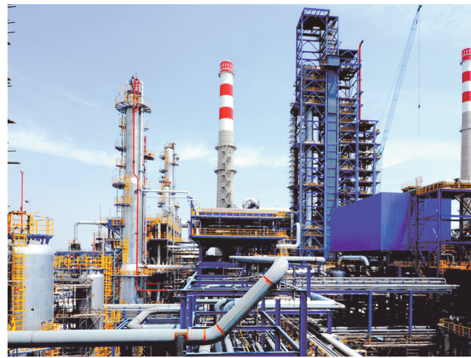
6月7日,位于任丘市的华北石化千万吨炼油升级改造项目施工现场。 记者 杜柏桦 通讯员 汪博摄
