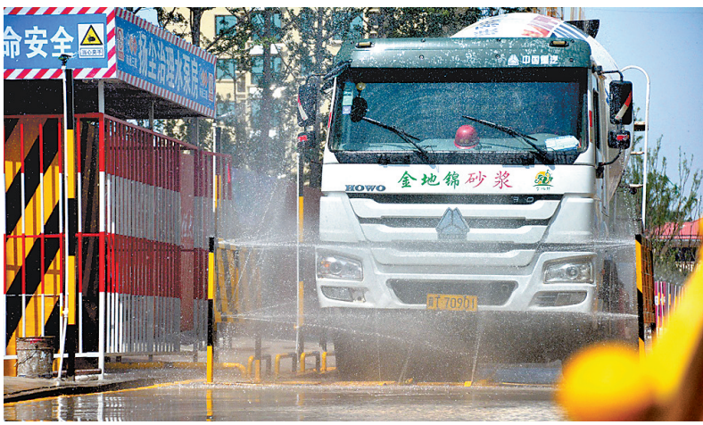
日前,衡水市区恒大城三期建筑工地内,一辆从工地驶出的车辆行驶到门口时,扬尘治理水泵立即喷出水来,将粘在车上的泥土冲洗得干干净净。
