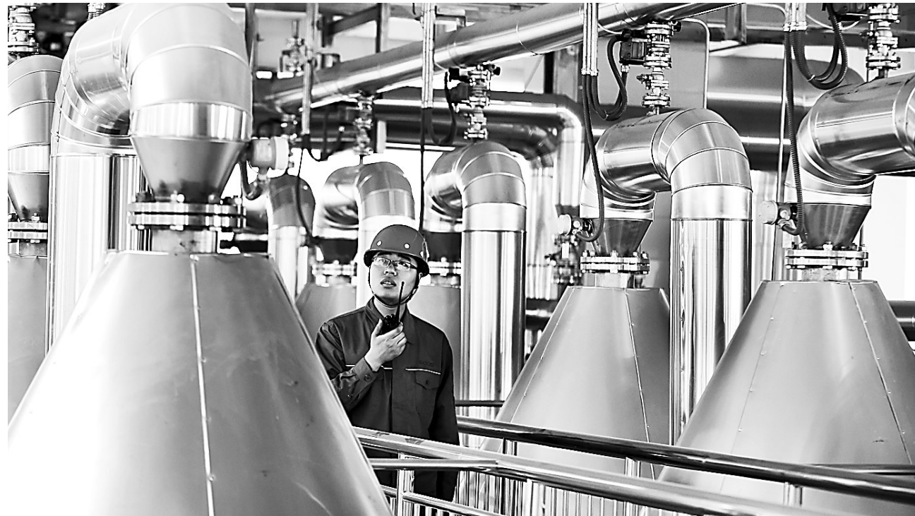
近日,工人在玉锋实业集团果糖车间巡检。宁晋县玉锋实业集团加大科研投入,建立了省级工程实验室和企业技术中心,力促研发成果产业化。该公司投资46.2亿元建设的玉锋大健康生物产业园项目,主要生产果糖、山梨醇等玉米深加工产品,使玉米附加值得到更大提升。记者 赵永辉摄
