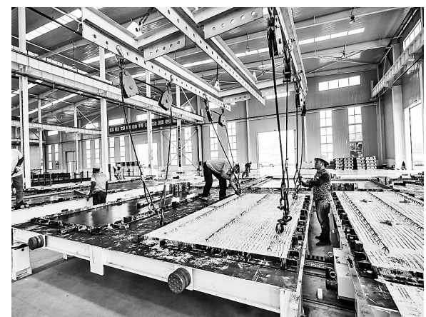
秦皇岛和信基业建筑科技有限公司PC车间于7月初通过项目验收并正式投产。车间建筑面积约2万平方米,包括2条预制构件自动化生产线及4条固定模板生产线。预制构件自动化生产线选用目前国内最先进的环形流水生产线,生产全过程为信息化控制,自动化程度高,部分设备可实现无人值守的工作模式。图为工作人员正在进行构件拆模起吊操作。
