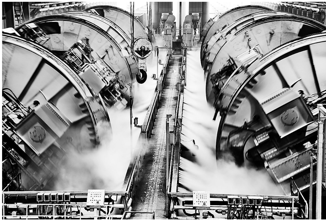
神华黄骅港务公司与驻黄骅港煤炭港区各单位团结协作、科学调配,全力提升港口卸车能力。7月份,黄骅港煤炭港区共计完成卸车4234列1801万吨,创开港以来单月卸车最高纪录。这是日前港区翻车机房设备运转情景。 通讯员 张凌凤 周海生摄
