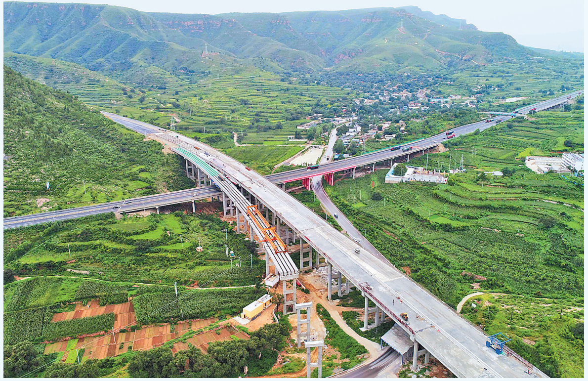
日前,由中电建路桥集团第四工程局承建的那汾高速分离立交桥主体工程全部完工。该立交桥全长607.5米,是太行山高速公路邢台段的重要控制性工程之一。
