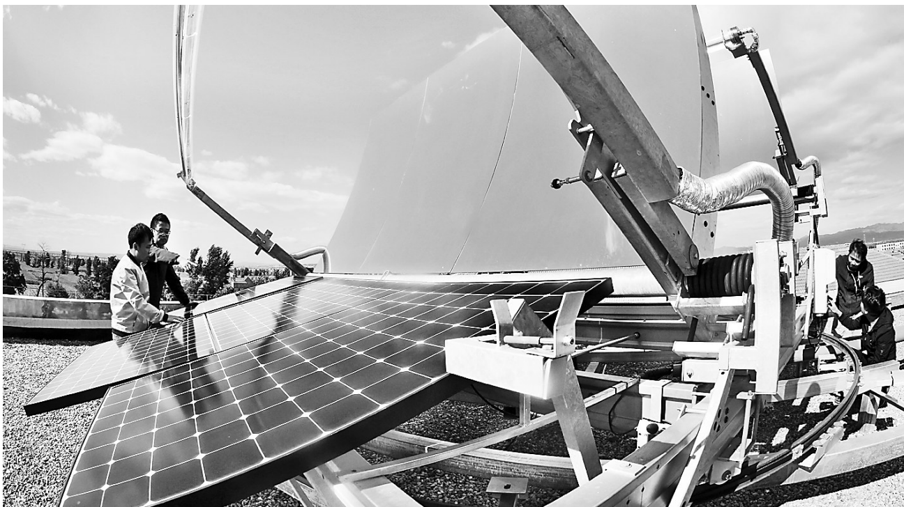
近日,张家口经开区太阳贝光伏发电示范点项目在该区东辛庄中学投用,为该校师生提供免费用电及饮用热水。该设备目前可供应学校每天所需饮用水1500升。下一步辅助系统完成后,可实现“太阳能+辅助供暖”系统,供应学校主楼3层的大部分用电和冬季供暖。
