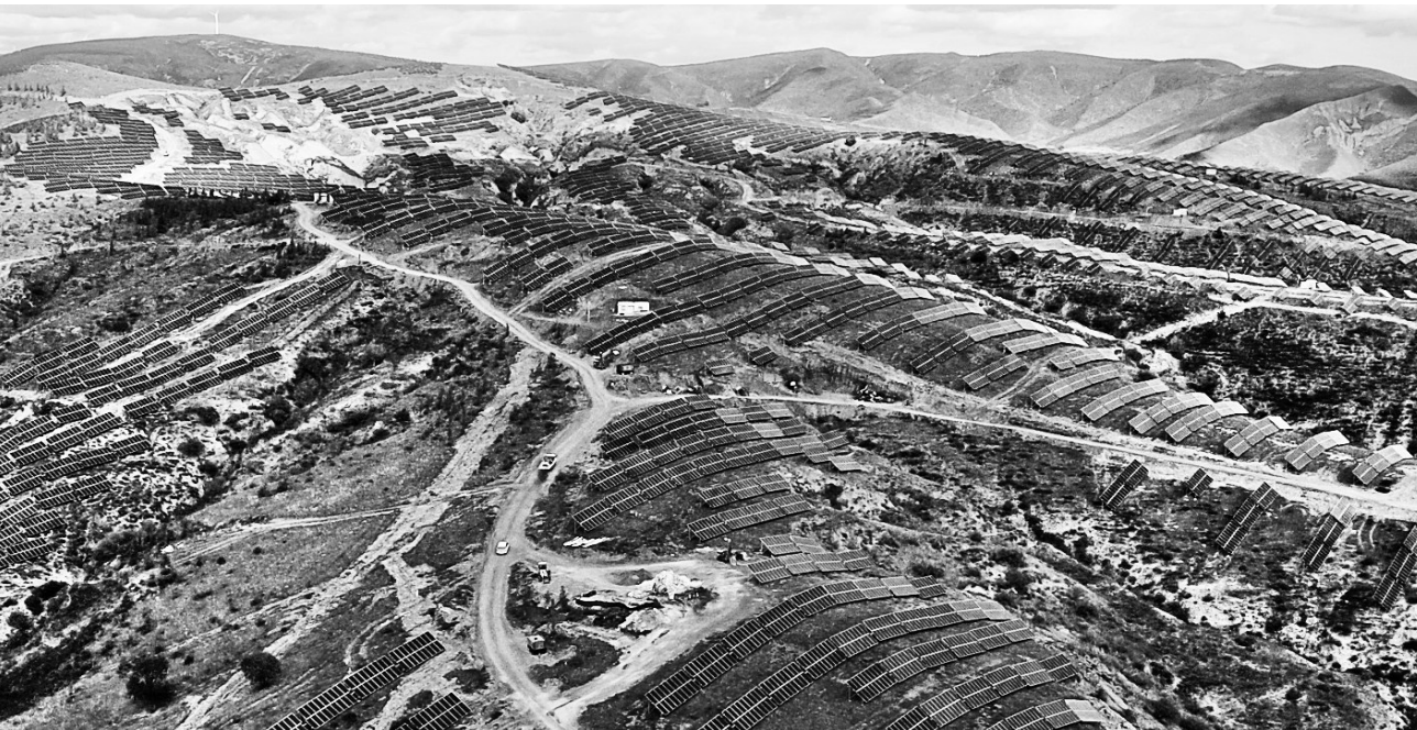
近年来,围场始终把产业扶贫作为全面打赢脱贫攻坚战的核心理念和贫困户增收的根本途径,依托资源优势 and 产业基础,计划投资17亿元,实施产业扶贫全覆盖工程。今年4月,围场实施了张家湾乡30兆瓦光伏扶贫电站项目。现已并网发电的扶贫电站,让荒置多年的山坡地变成了阳光银行。这是张家湾乡30兆瓦光伏扶贫电站。 记者 陈宝云 通讯员 孙占军摄
