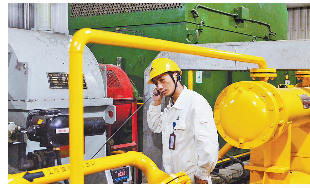
11月15日,国华定州电厂工作人员在使用听针设备对热网循环泵进行巡检。该电厂现有的4台纯凝发电机组已全部完成改造,为定州市区提供了清洁能源供暖。记者 张昊 通讯员 白永民摄
