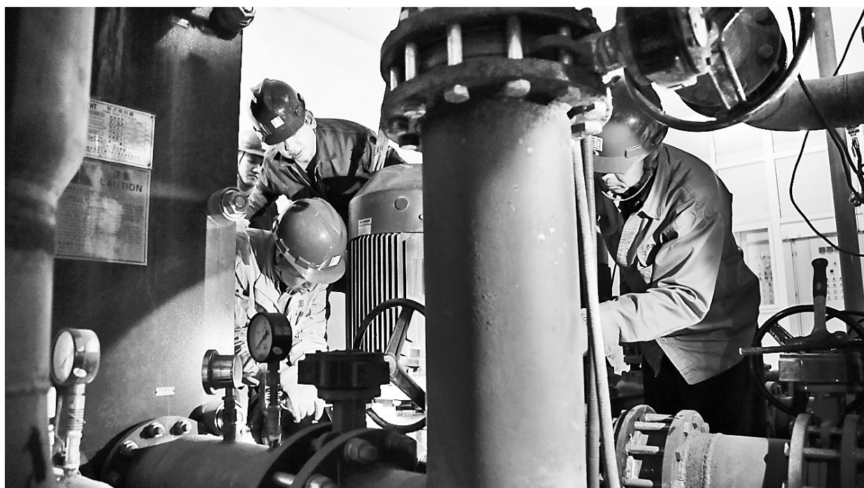
为保证居民温暖过冬,大唐保定供热公司投入检修费用4000多万元,对21个项目进行专项检修,目前保定市区已开始正常供暖。通讯员 张萌超摄
