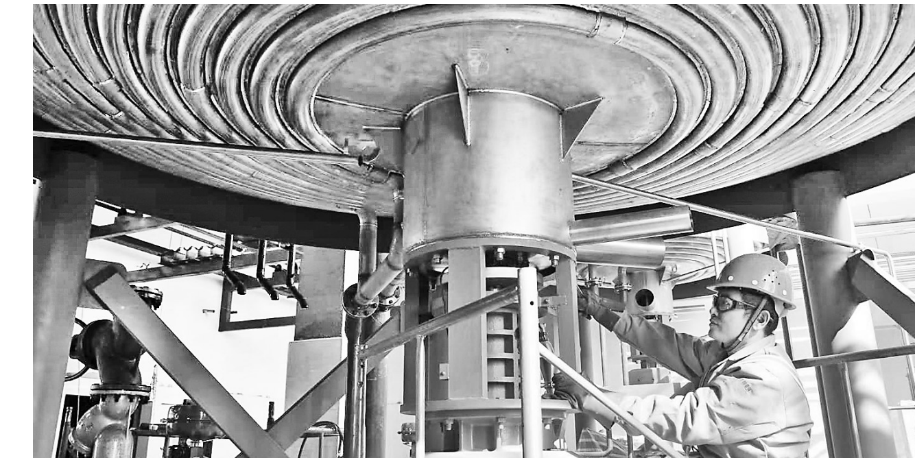
近日,在位于宣化区北山工业园区中的青岛啤酒张家口工业园,工人在进行过滤槽安装工作。近年来,宣化区将位于城区内的钟楼啤酒厂迁出,引进青岛啤酒有限公司在北山工业园区新建了青岛啤酒张家口工业园。工程将于今年年底建成投产,达产后年产啤酒60万千升,可安置2000名劳动力就业。记者 刘雅静 通讯员 陈晓东摄
