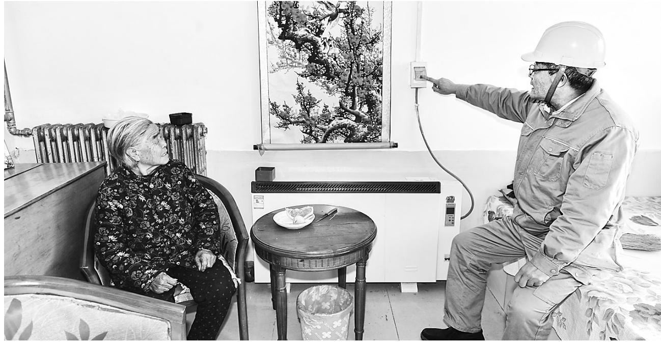
11月21日,香河县前建各庄村的电工在83岁的王淑珍家了解清洁取暖设备运行情况。近年来,香河县累计完成电代煤、气代煤改造90466户,保障了群众清洁温暖过冬。 记者 田明摄
