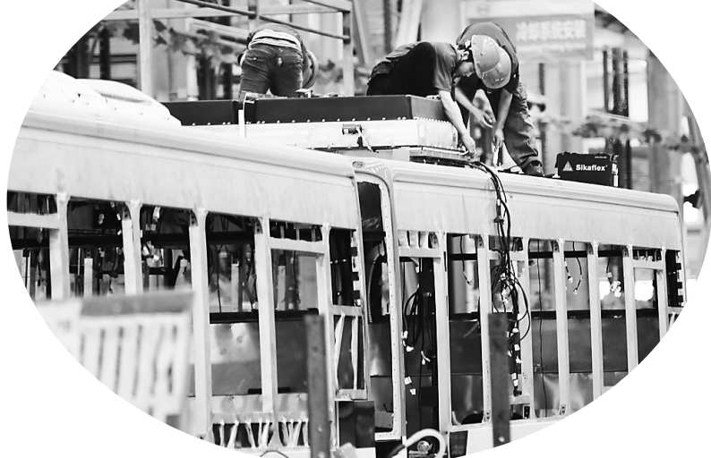
▲今年，承德将加快特色装备制造产业，一核、四组团布局，大力发展新能源汽车及汽车零部件、发动机生产制造。这是承德比亚迪汽车公司的电动公交车生产线。
