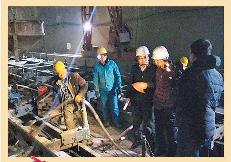
▲冬奥保障工程崇礼铁路新兴堡隧道施工现场。通讯员 曲志忠摄
