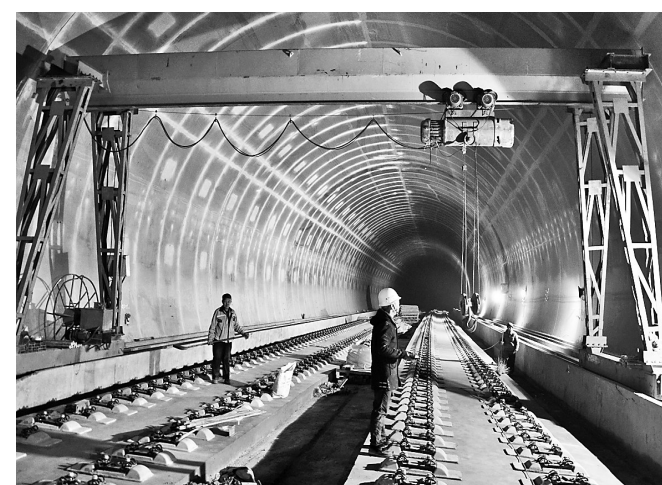
日前,由中铁二十局二公司承建的北京2022冬奥重点配套工程——崇礼铁路新兴堡隧道无砟轨道道床浇筑全部完工。新兴堡隧道无砟轨道道床单线全长4144米,为全线重难点控制性工程。这是无砟轨道完工后,工人们在清理场地。 通讯员 曲志忠 记者 李艳红摄
