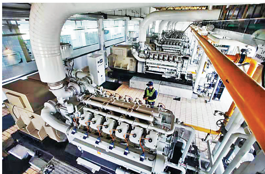
察北现代牧业沼气发电设施。 通讯员 武殿森摄
