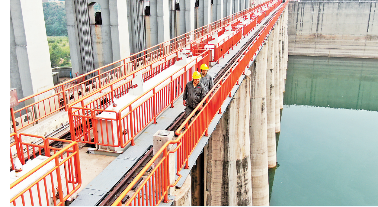
7月18日,石家庄市黄壁庄水库工作人员在巡检非常溢洪道的建筑和设备。进入主汛期以来,黄壁庄水库管理局全体人员24小时在岗值守,同时对防汛抢险人员进行培训,对重点坝段制订了抢险方案,全力确保水库安全度汛。 记者 赵杰 通讯员 赵彦彦
