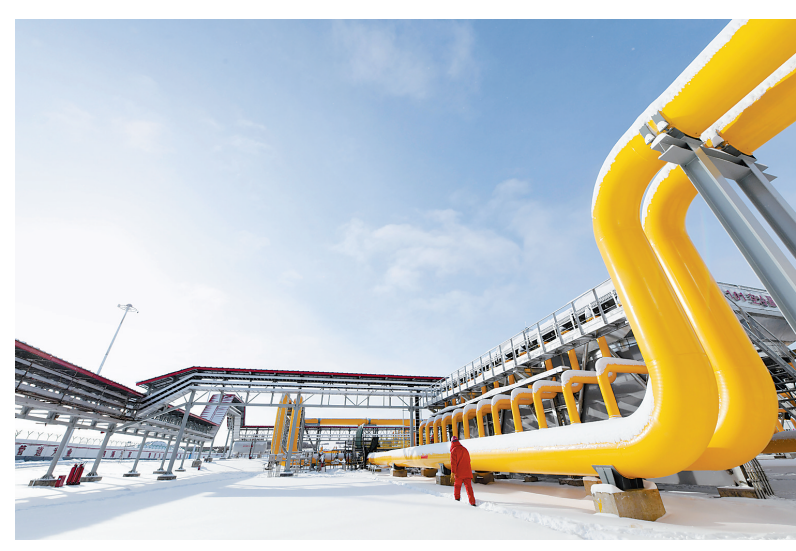
在中俄东线天然气管道北段黑河首站场区,工作人员从管线旁经过(11月19日摄)。 新华社记者 王建威摄
