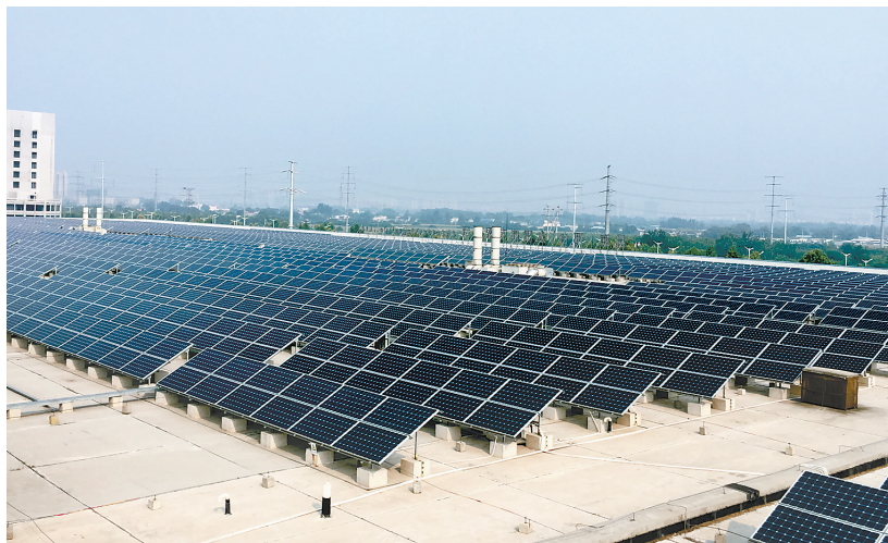
晶澳(邢台)太阳能公司利用厂房屋顶安装的分布式光伏电站,平均每天发电超过1万千瓦时。
