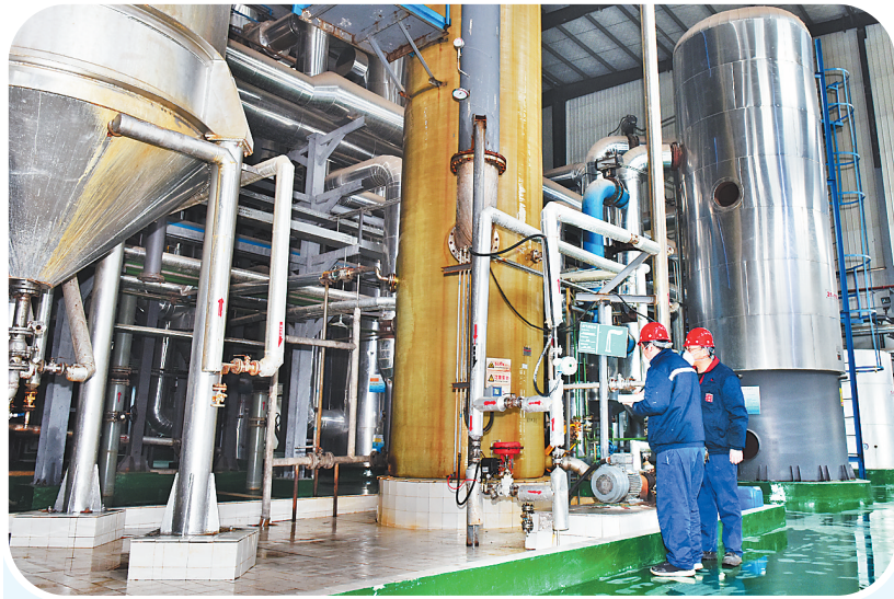
▲在河北赞宇科技有限公司消毒液生产线,工作人员正检查仪表压力,确保疫情防控期间实现安全生产。 河北日报通讯员 王占林摄
