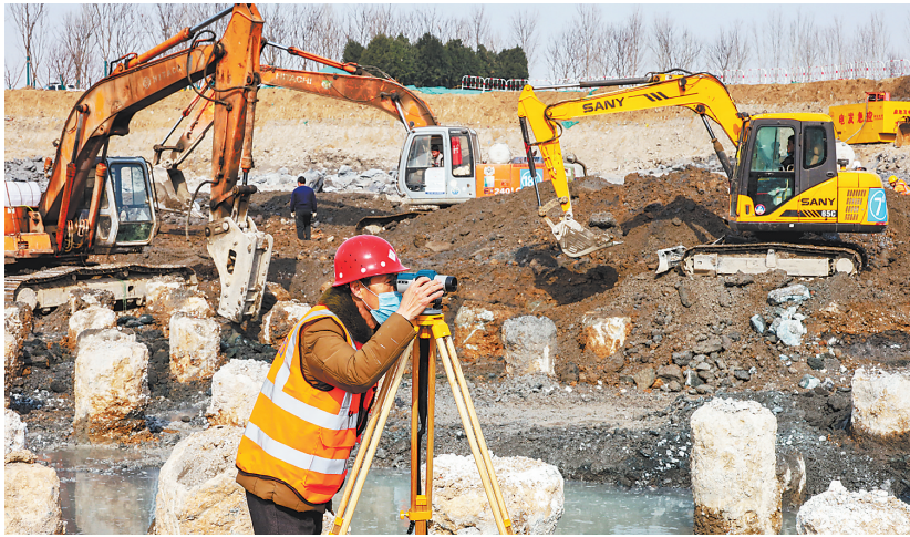
第四届省园博园项目建设现场,一名测量员正在用水准仪测量场地基底标高。截至目前,该项目复工率达80%以上。河北日报通讯员 董彦斌摄
