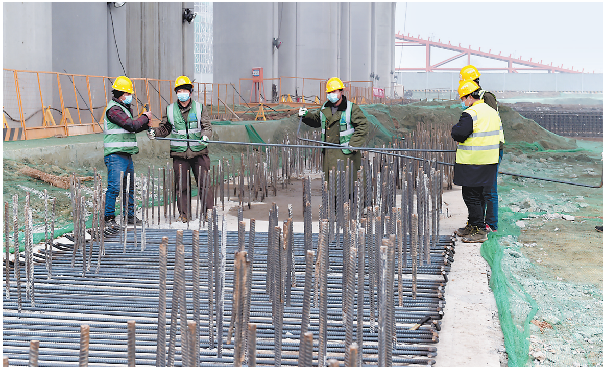
正在推进。京雄城际铁路雄安站的配套项目△快速路(一期)项目 河北日报通讯员 刘向阳摄
