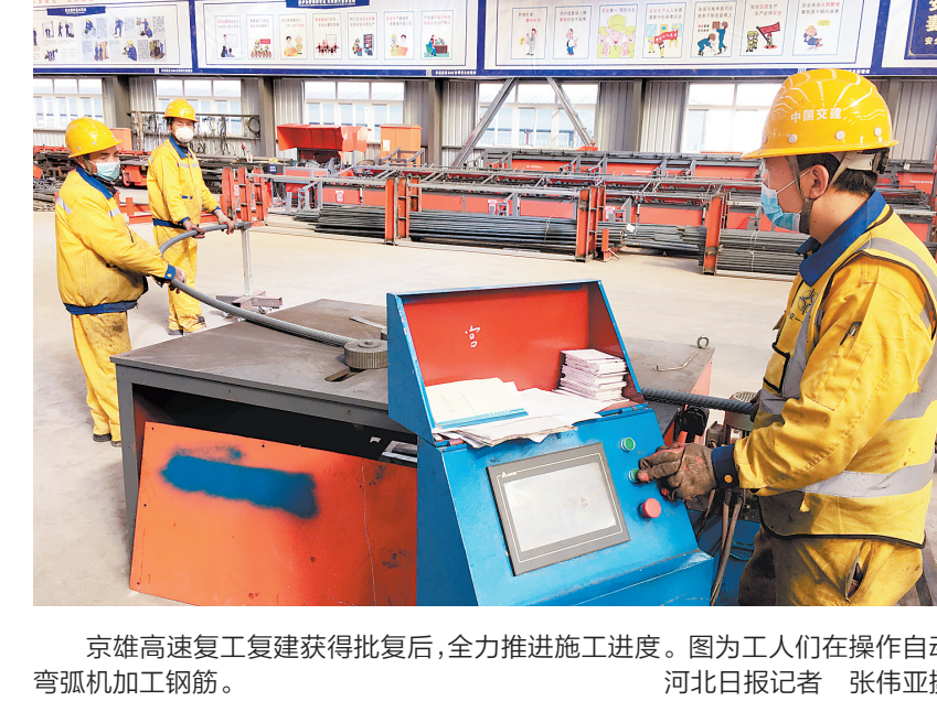
京雄高速复工复产获得批复后,全力推进施工进度。图为工人们在操作自动弯弧机加工钢筋。 河北日报记者 张伟亚摄
