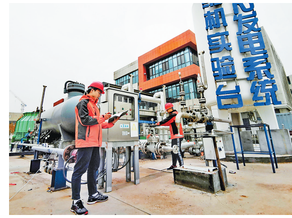
近日,衡水中科衡动力装备有限公司科研人员正在记录超临界二氧化碳试验机组中试项目的运行数据。近年来,该公司与中科院工程热物理研究所合作,开发了超临界二氧化碳发电装备项目,该项目的光热发电技术属于世界级前沿科技之一。河北日报记者 焦磊摄
