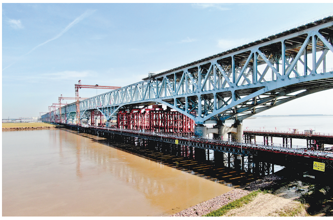
这是5月19日拍摄的施工中的郑济铁路郑州黄河特大桥。当日,由中铁大桥局承建的国家重点工程——郑(州)济(南)铁路郑州黄河特大桥主桥钢桁梁顺利合龙。郑济铁路郑州黄河特大桥主桥全长2016米。新华社记者 朱祥摄
