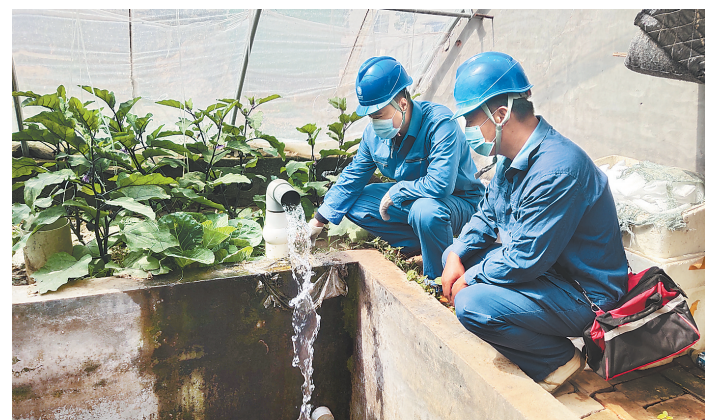
日前,国网沧州市渤海新区供电公司共产党员服务队队员在检查种植户大棚水泵用电安全。为保障疫情防控期间大棚种植户安全可靠用电,该公司组织共产党员服务队深入南大港产业园区扣村蔬菜大棚种植基地“零距离”开展服务。河北日报通讯员 田浩摄
