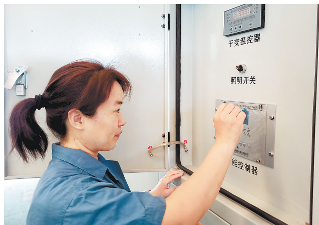
7月6日,在河北博为电气股份有限公司,工作人员正在进行智能电气设施安装。河北日报记者 曹智摄
