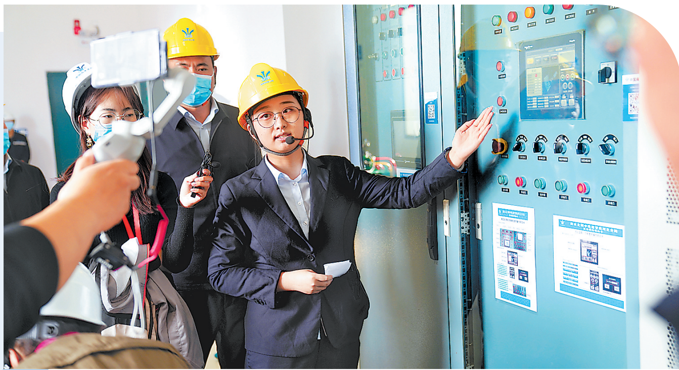
在南水北调中线建管局河北分局举办的开放日活动中,工作人员向嘉宾讲解闸门启闭工作原理。河北日报记者 马彦铭摄
