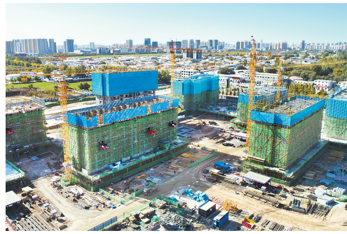
日前,保定市深圳园项目正在建设中。该项目由保定与深圳两地政府合作建设,重点发展信息智能产业,将成为推动保定市高质量发展的新样板。 河北日报通讯员 曹云鹏摄
