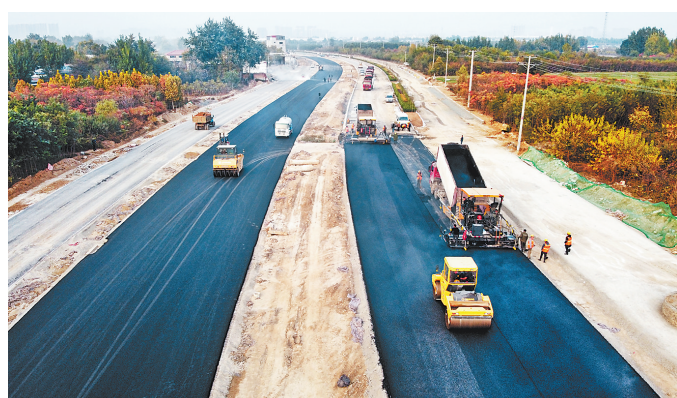
近日,保定市乐凯大街南延工程地面辅路在进行沥青混凝土摊铺作业。乐凯大街南延工程是保定市重点工程,位于市区西南部,全长11.93公里。目前,部分路段已通车。河北日报记者 赵永辉摄
