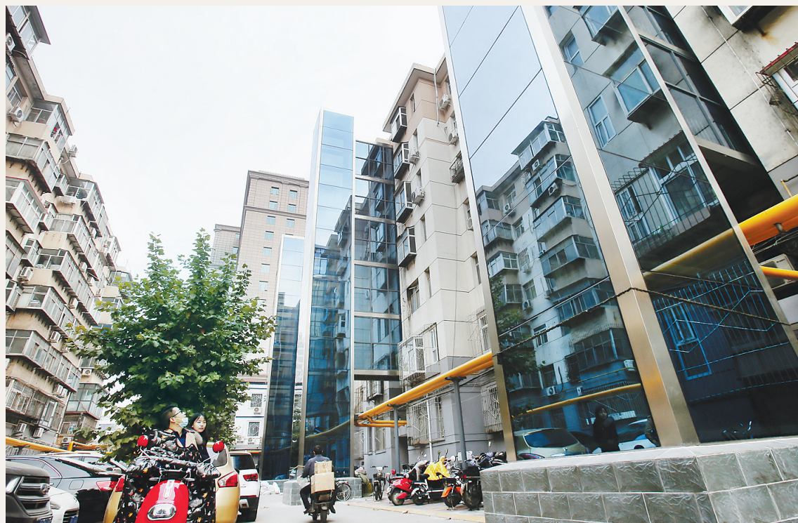
河北省石家庄市新华区华泰家园小区9号楼室外电梯的安装完成框架施工。
