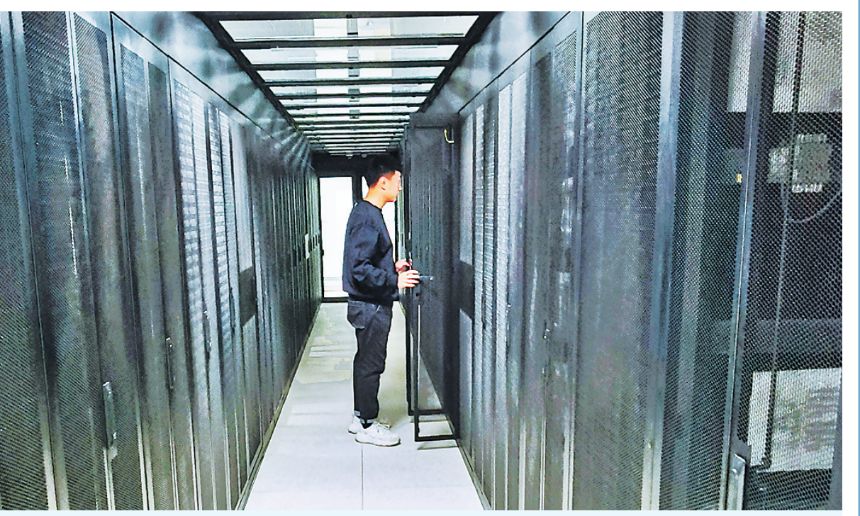
在承德高新区科技大厦数据中心楼机房内,技术人员在进行日常巡检。京承高速直连光缆终点数据机房就在楼内。(河北日报资料片) 河北日报通讯员 张君有摄
