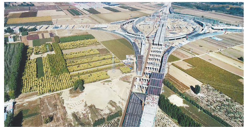
110千伏电力线路跨越京雄高速、荣乌高速互通迁改施工现场。
