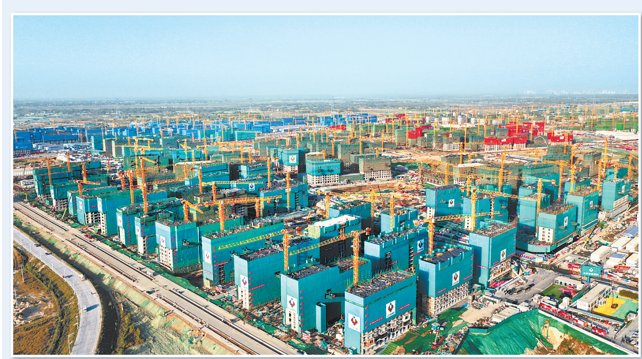
这是2020年11月6日拍摄的雄安新区容东片区安置房项目建设现场(无人机照片)。(资料片) 新华社记者 牟宇摄
