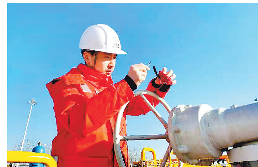
国家管网集团北方管道公司廊坊输油气分公司永清联络压气站受访职工在站场维护设备。
