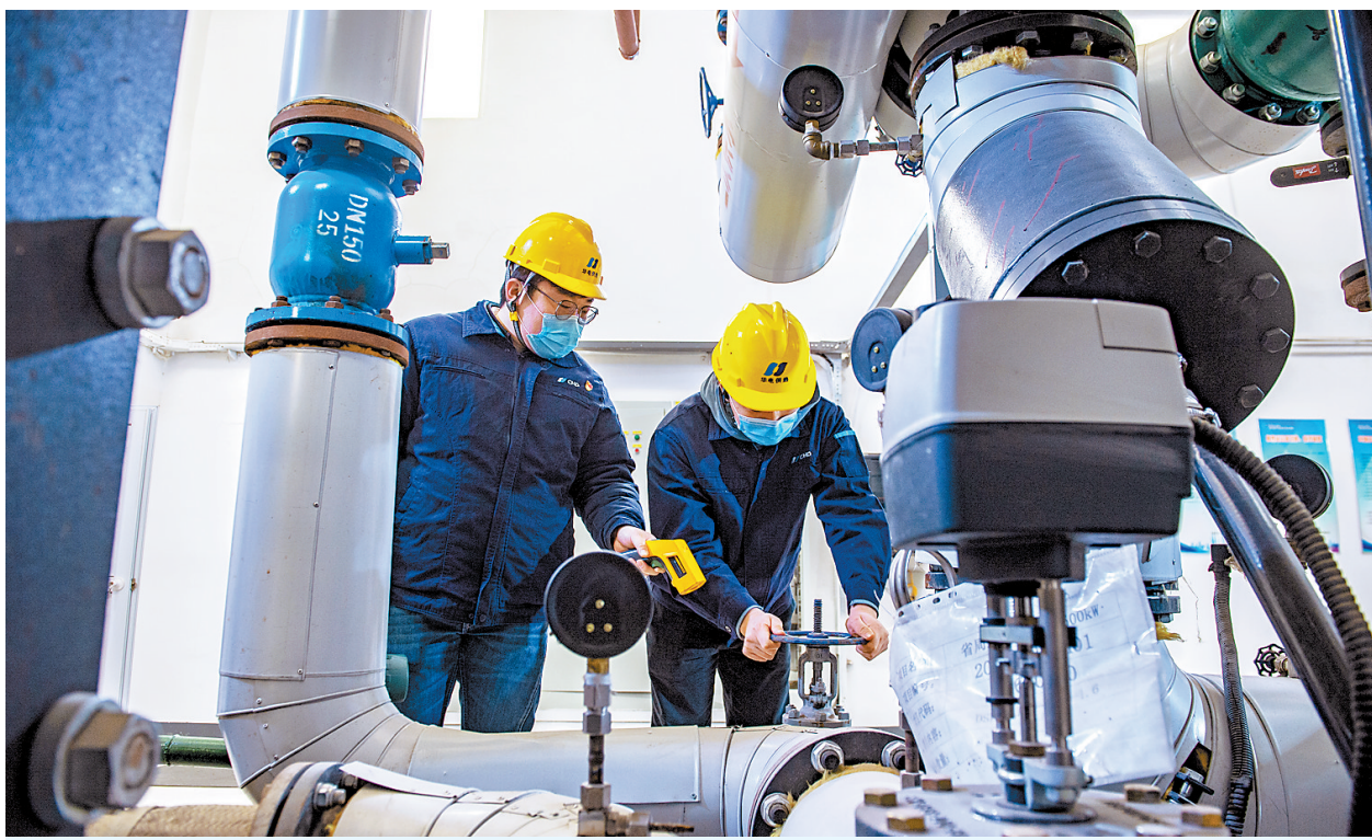
3月15日,石家庄华电供热集团有限公司的工作人员在检查换热站设备,保障正常供暖。为确保低温天气、常态化疫情防控形势下群众用热需求,省委、省政府研究决定延长供暖时间。河北日报记者 田明摄
