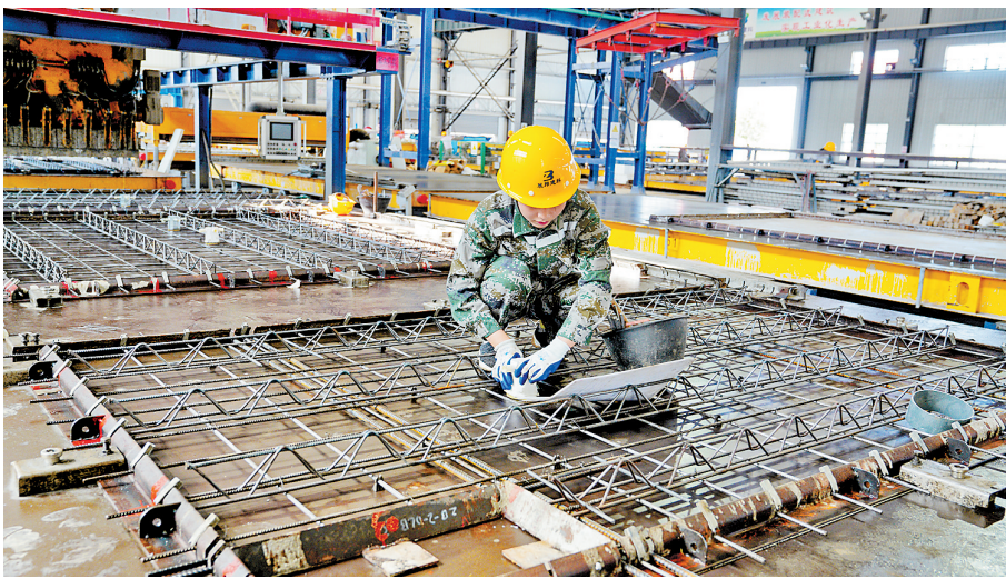
日前,在河北展邦建筑科技有限公司生产车间,工人正在进行装配式建筑叠合板电线的预埋作业。 河北展邦建筑公司供图
