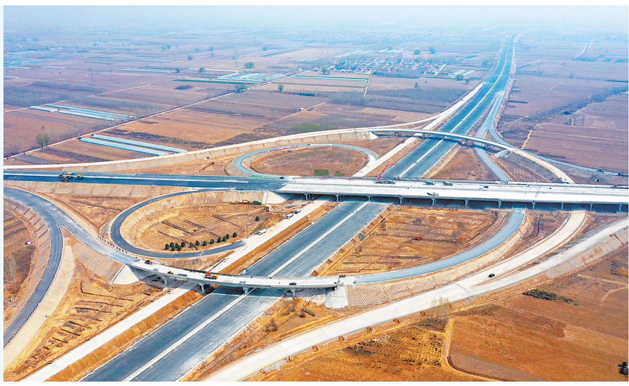
3月25日,航拍建设中的荣乌新线、京德高速公路互通工程。 位于永清县的荣乌新线、京德高速公路互通采用变形苜蓿叶形枢纽型互通,交叉方式为京德高速上跨荣乌新线,互通工程占地707.06亩。荣乌新线、京德高速公路永清段总长37.87公里,在永清内设有3个互通出口。工程将于今年5月建成通车,届时将进一步改善该县交通条件,为当地经济社会高质量发展带来更多机遇。 河北日报记者 赵永辉摄
