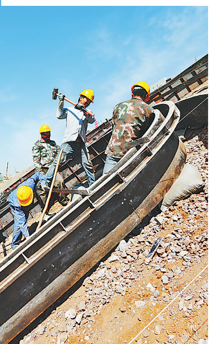
近日,工人们在为京唐城际铁路唐山西站护坡支模。 河北日报通讯员 郭宝强摄
